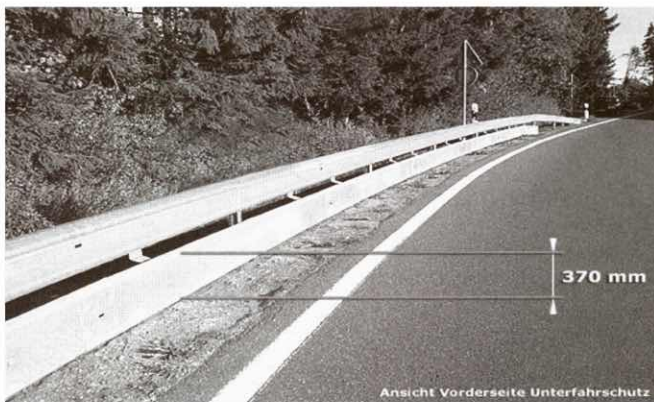
Wirkungsvoll verhindert der Unterfahrschutz den Kontakt mit den scharfkantigen Leitplankenpfosten. (Fotos: Schwill)
